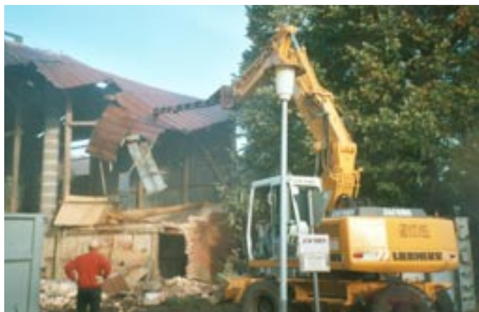
Unser Dorf soll noch schöner werden. Abriss der alten Scheune (ehemals Hof Gosch)
